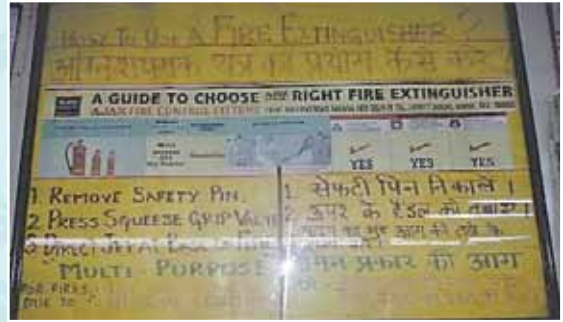
Instructions for Use of Fire Extinguisher આગ હોલવવાનાં સાધનના ઉપયોગ માટેની સૂચનાઓ
