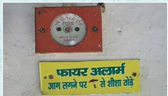
Emergency Fire Alarm Point આપાતકાલિન ફાયર એલાર્મ પોઇન્ટ
