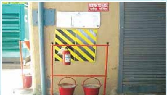
Fire-Fighting Equipment આગ સામે લડતા ઉપકરણ
